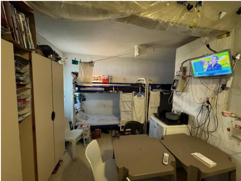
Cellule collective (fuite d'eau au plafond contenue par du plastique)
